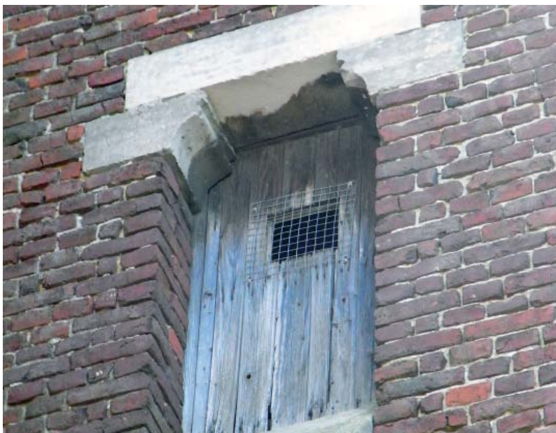
Figure 9 : Passage potentiel obstrué par un grillage (Source : Artemia Environnement)
