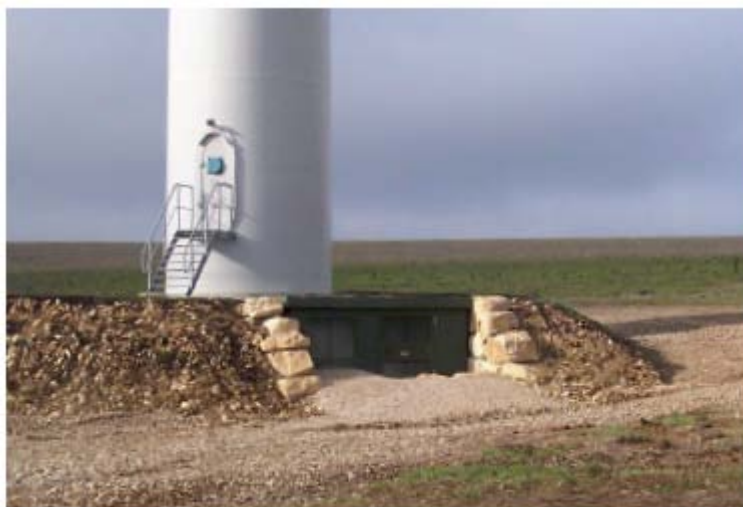
Figure 24 : Exemple d'intégration d'un poste de transformation (source : Maïa Eolis)
